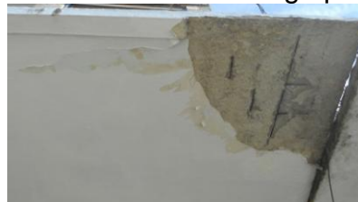
Figura 1 – Marquise com deslocamento do revestimento e do concreto e, armadura exposta.
