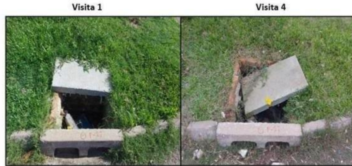
Figura 3 – Fotografia da estrutura danificada.
