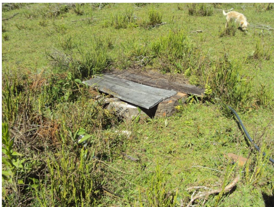
Foto. Tampa de madeira em mau estado de conservação. Fonte: autor
