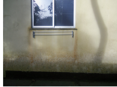
Figura 6: Manchas e sujidades causadas pelo mau desempenho das pingadeiras. Foto da autora.
