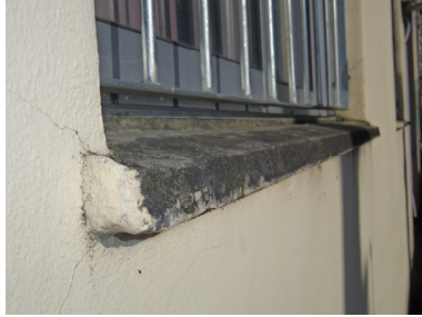
Figura 5: Fissuras devido à movimentação higroscópica. Foto da autora.
