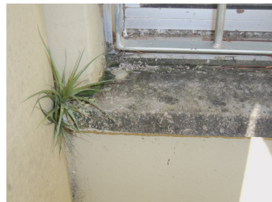
Figura 7: Vegetação e fungos gerados devido à retenção da umidade. Foto da autora.
