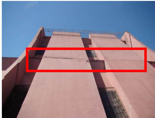
Figura 1: Fissuras causadas por movimentação térmica dos materiais. Foto do autor.
