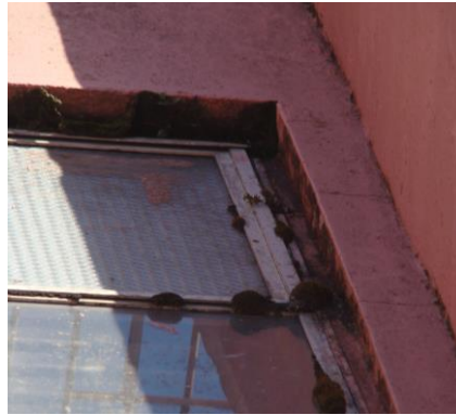
Figura 2: Vegetação causada pelo acúmulo de água e falta de incidência solar. Foto do autor.
