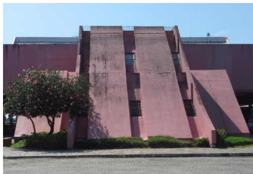
Figura 3: Sujidades causadas por falta de manutenção. Foto do autor.
